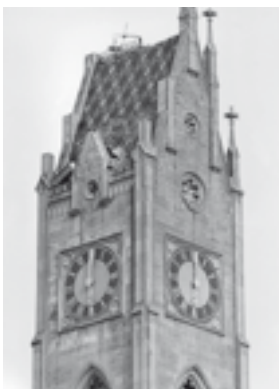
Teilansicht des stark beschädigten Turms nach der Unwetterkatastrophe vom 15. August 1982. KDP Fotoarchiv.
